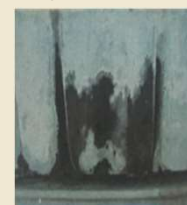
Figura 13 - Presença de pátina na cúpula de cobre da torre
