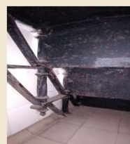
Figura 12 - Escada de serviço com pontos de corrosão
